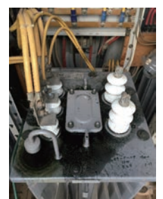
事故を起こした変圧器
