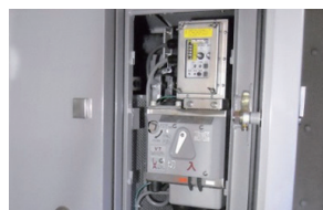
UGSが取り付けられた 高圧キャビネット
