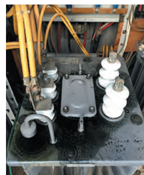
事故を起こした変圧器
